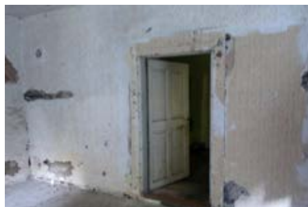
Stanje pred obnovo
